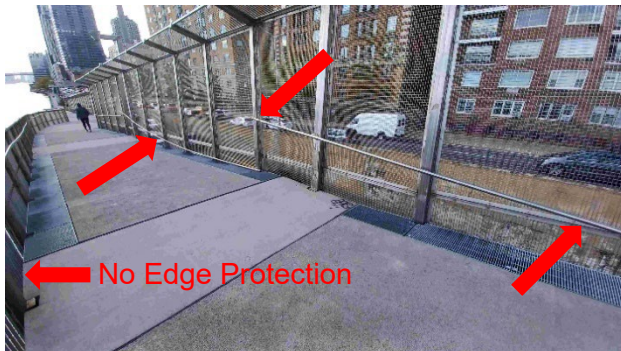
Broken Handrails / No Edge Protection
